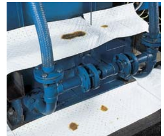
...of rond en onder machines om lekken en spatten op te vangen.
